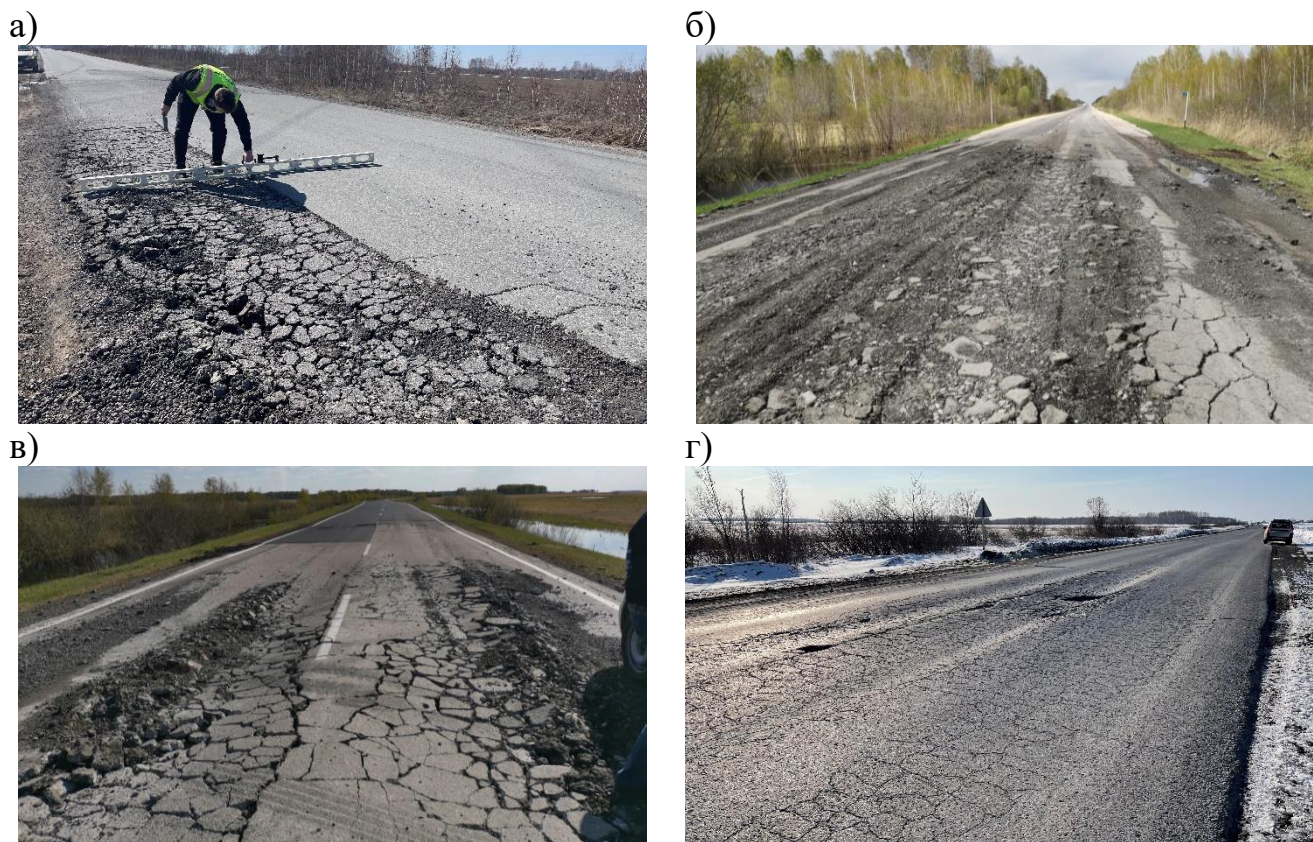
Рисунок 1.4 – Примеры характерных последствий от образования пучин на участках автомобильных дорог в Новосибирской области
